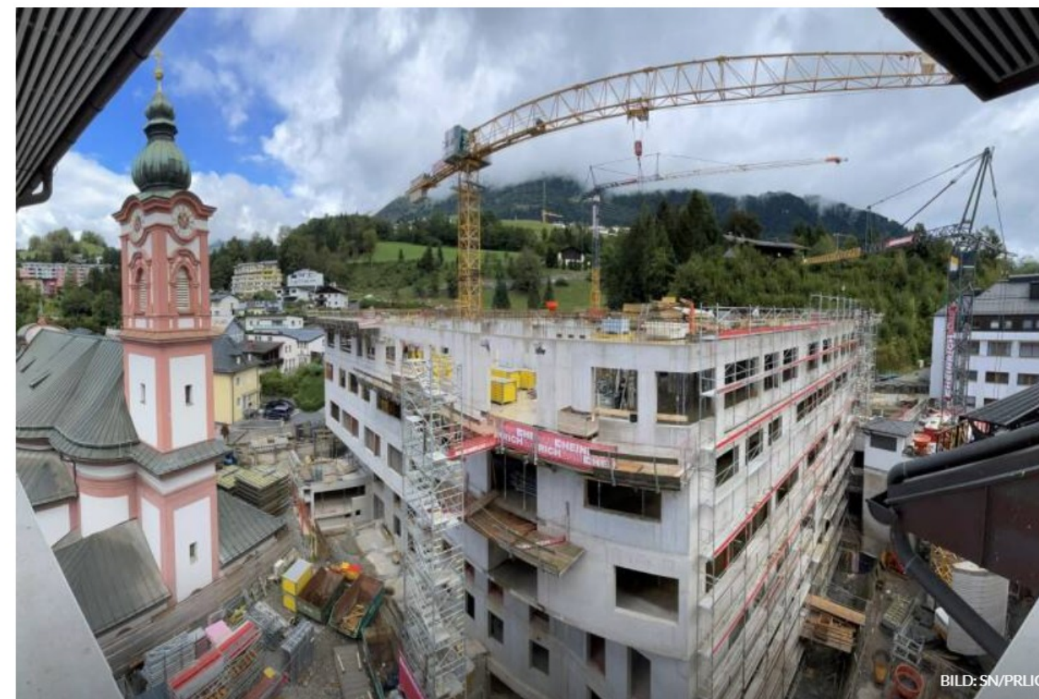
Auf sieben Geschoßen entsteht ein neues Gebäude für Psychiatrie, Spitalsapotheke, und neue OP-Säle.
